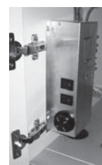
Lämpöaltaan virtakytkin ja termostaatti
