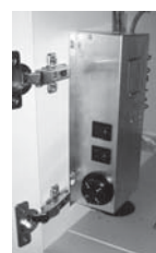
Lämpöaltaan virtakytkin ja termostaatti
