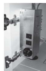
Lämpöaltaan virtakytkin ja termostaatti
