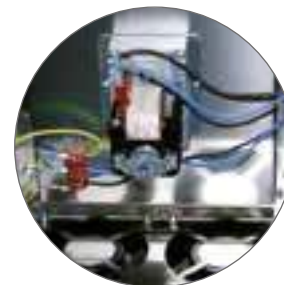
Ventilation des moteurs / Motors ventilation
