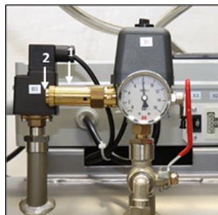
Fig. 17: Contrôle de la soupape de sécurité
